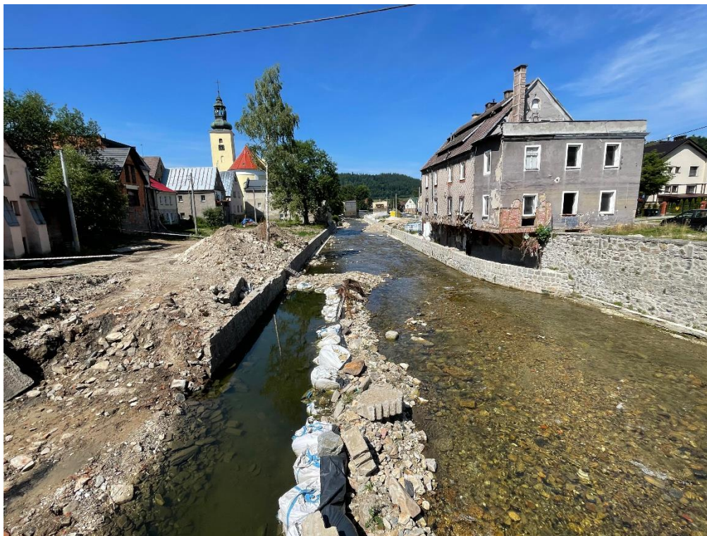
Rysunek 1. Uszkodzenia koryta Białej Łądeckiej w Łądku-Zdrój po przejściu powodzi we wrześniu 2024 roku.
